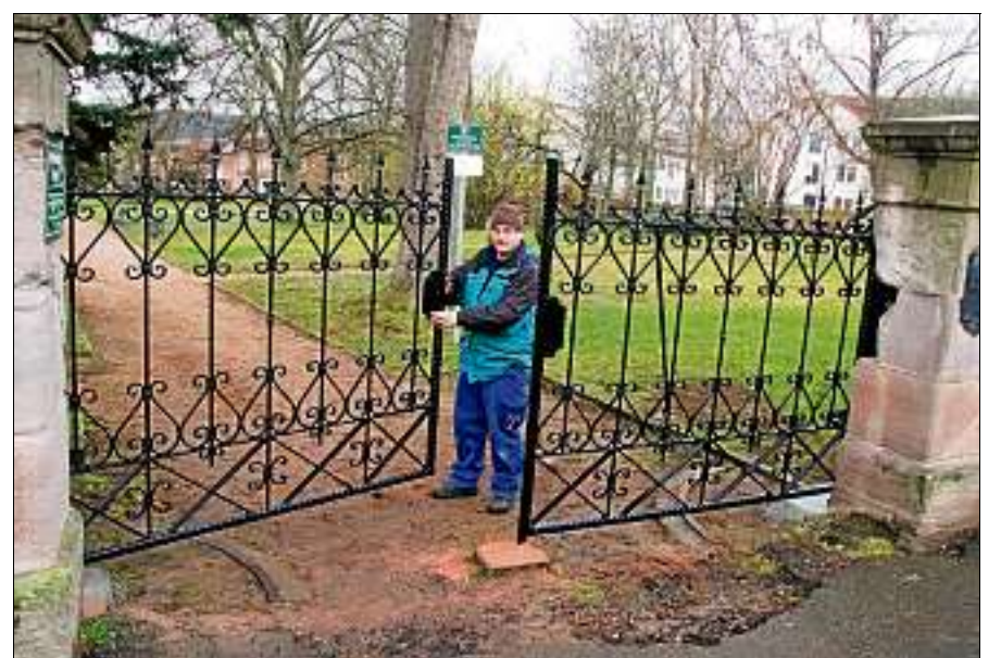
Frank Becker von Schlosserei und Metallbau Bad Frankenhausen fertigte das neue Haupttor für den Botanischen Garten. Fotos: Ingolf Gläser
